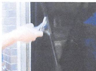
ガラス面にこの様な角度で接触させた場合、中のチャンネルが露出するケースがあります
